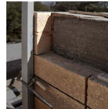
Ref.09 Forjado de vigas de madera con zuncho perimetral de hormigón armado, aparte de unir sirve para repartir el peso de las vigas encima de la pared estructural.
