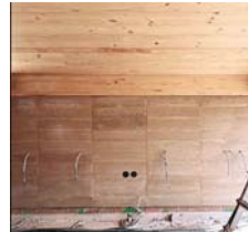
Ref.03 Instalaciones por la cara interior del muro visto Installations on the interior face
