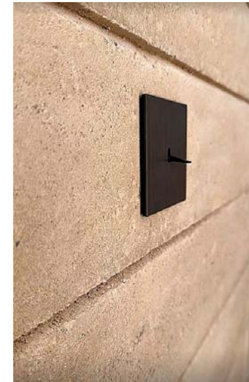
Ref. 01 Detalle de los interruptores Switches detail
