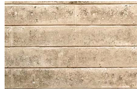
Ref.01 Bloques de gran formato colocados a rompe-juntas con junta vertical mínima y junta horizontal biselada
